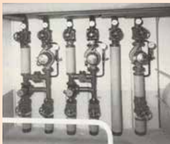
Verteilbatterie Heizung Kolonie Katzenbach
