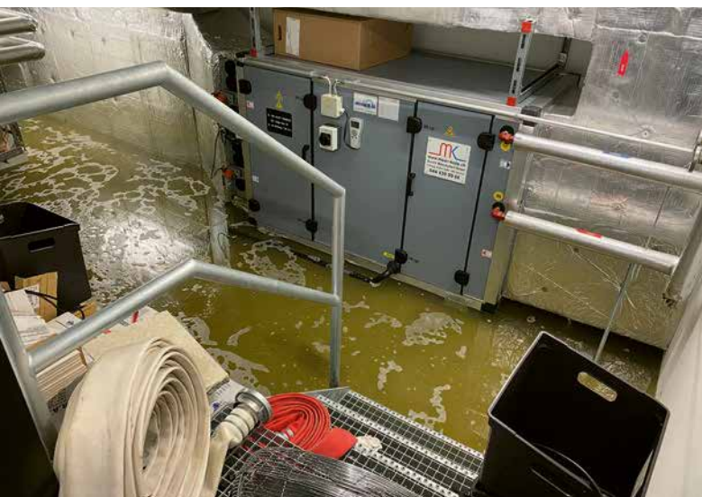
Überflutete Technikzentrale im Glattpark ebenfalls am 13. Juli 2021
